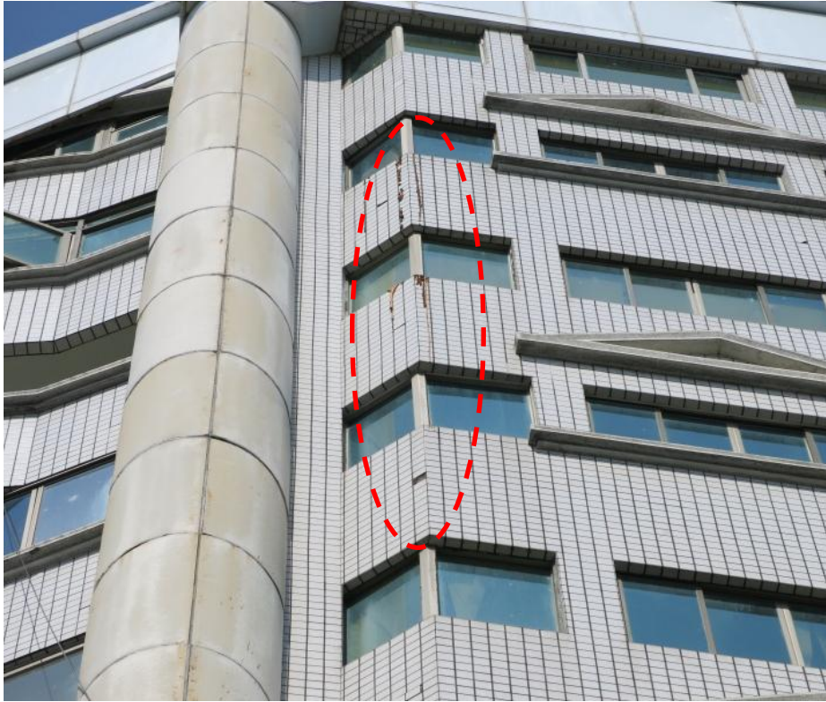
東向及南向的立面磁磚 開始產生爆裂並掉落
