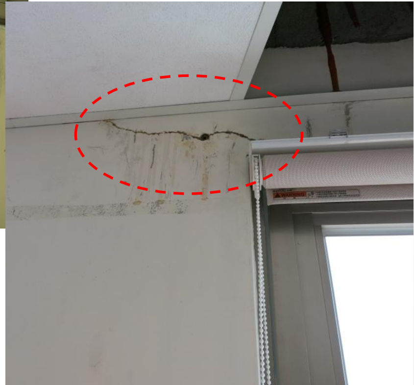
外牆結構體裂縫造成滲水現象
