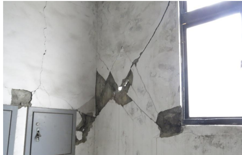
牆體嚴重裂痕
