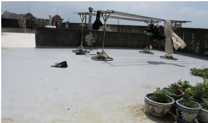
頂樓漏水情況(已塗防水漆處理)
