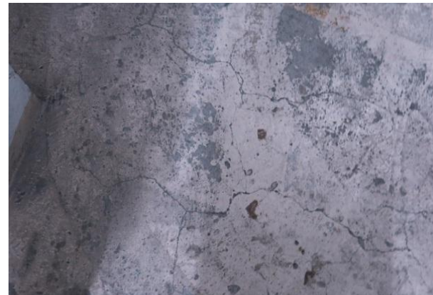
地下室停車場地面水泥龜裂
