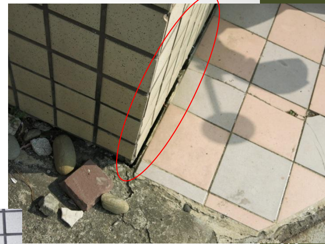
外牆立面與地面 交接處有溝縫
