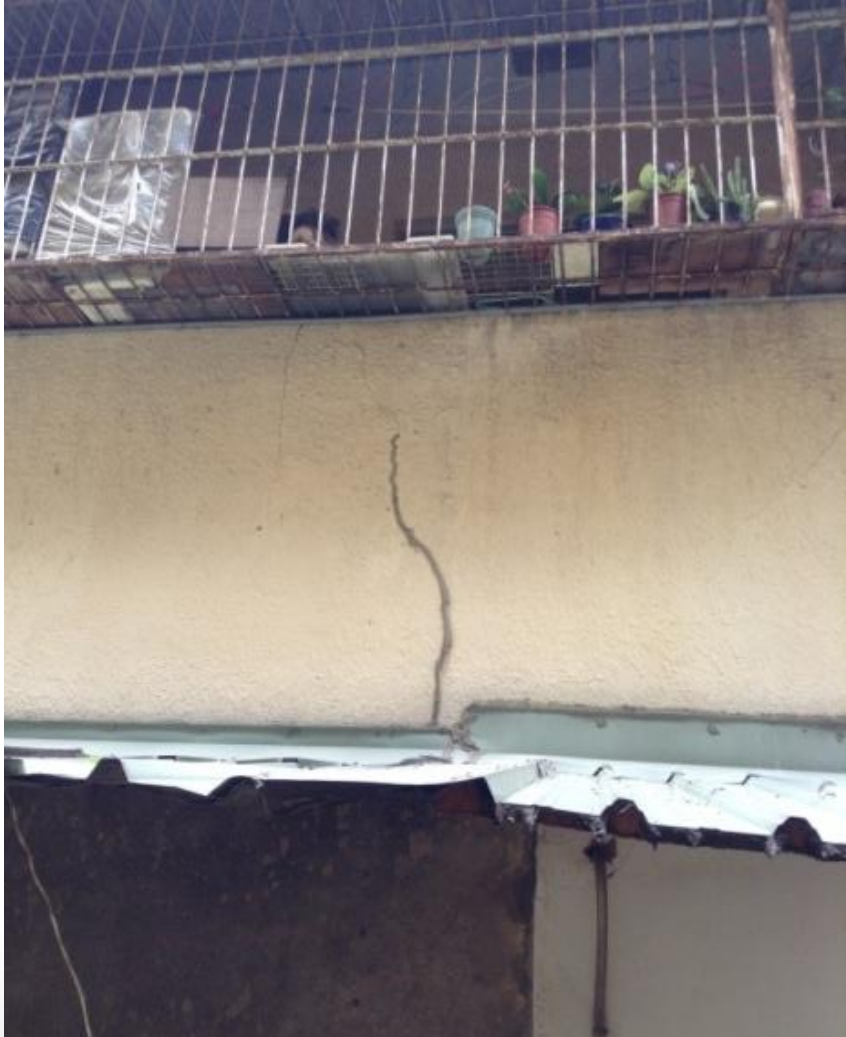
牆面龜裂、水泥剝落
