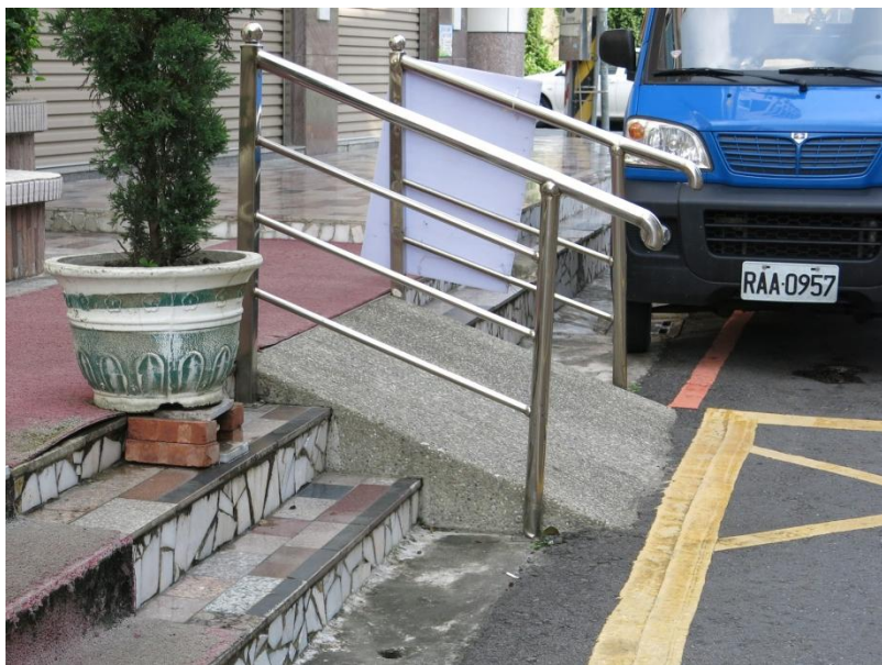
無障礙坡道過斜
