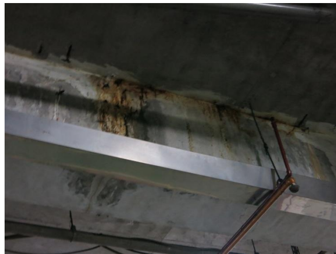
地下室嚴重滲漏水
