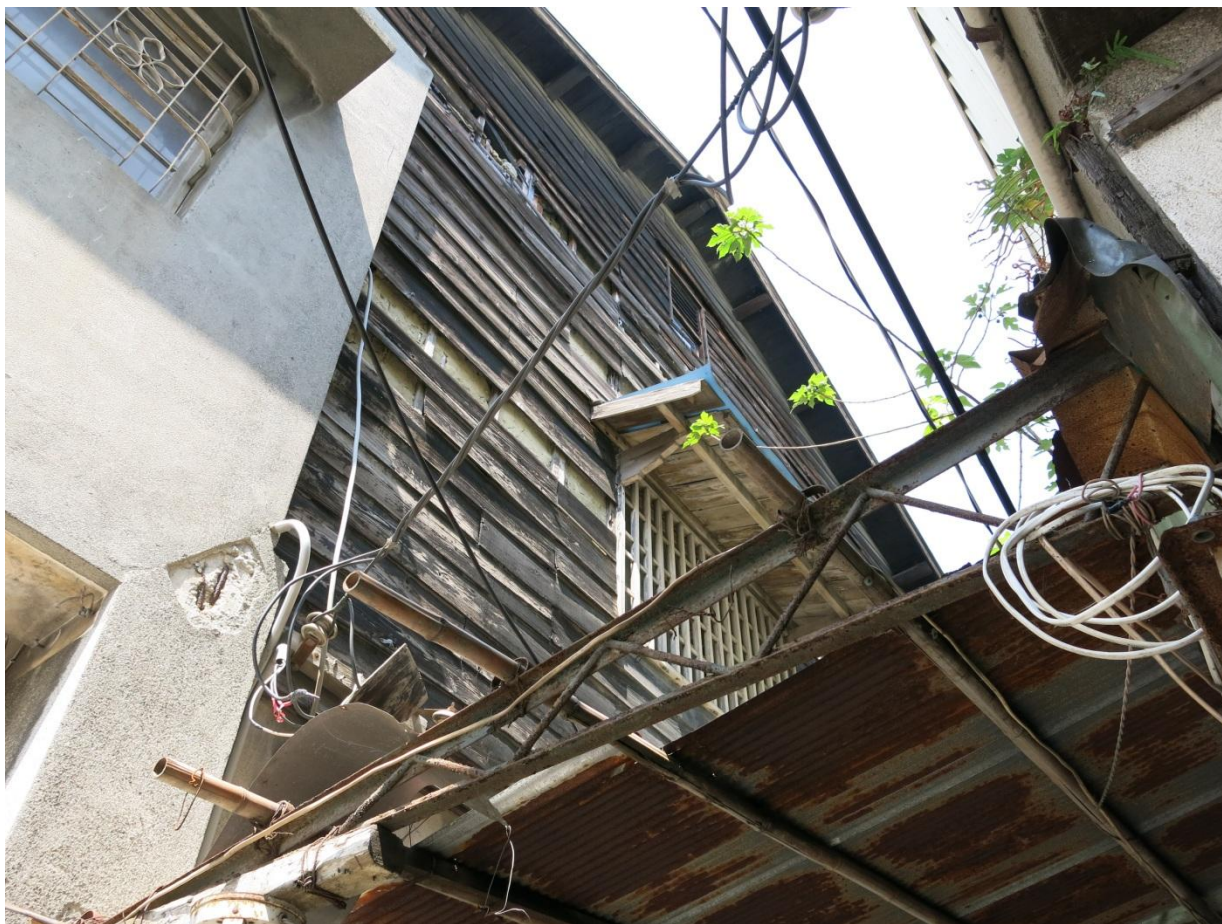
管線凌亂外露
