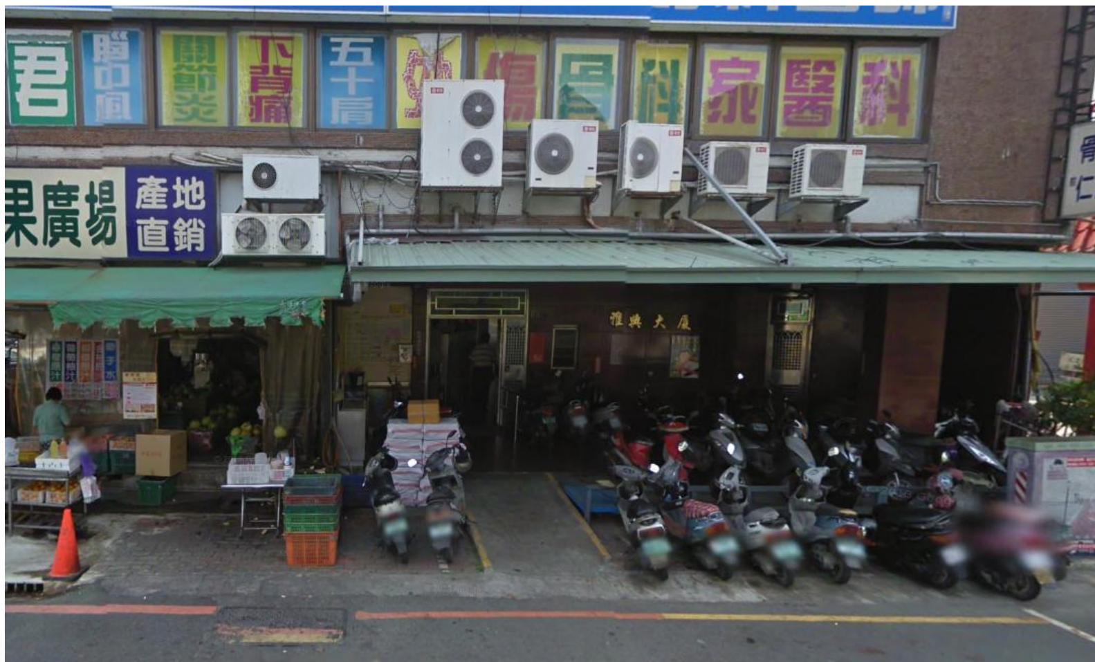
建築物出入口缺乏無障礙設施
